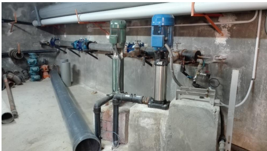
Imagen. Caseta Reelevadora del Depósito El Parque.
