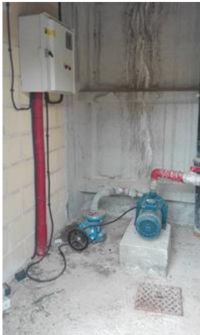
Bomba de la Reelevadora en el Depòsit Nou (Grande) de Beniaia.
