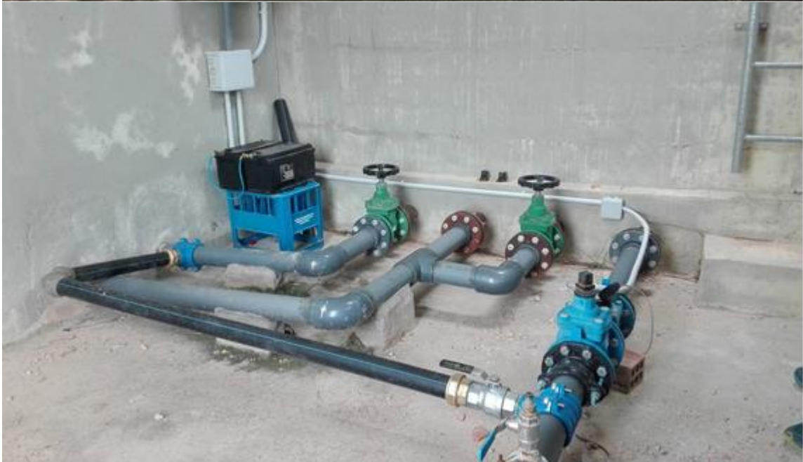
Depósito Grande (Cabecera)
